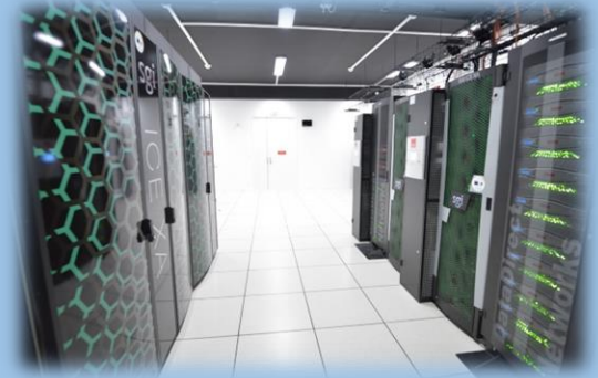
Datarmor Data Center
